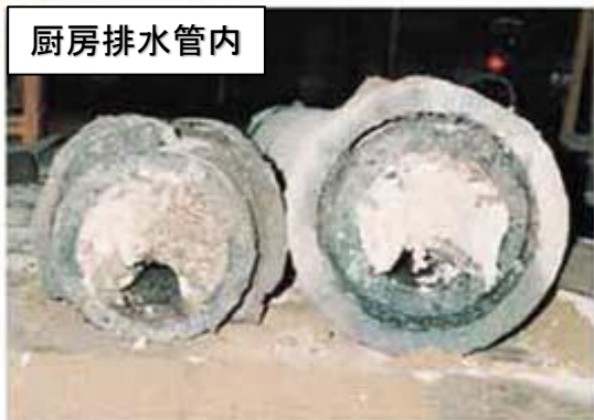
▲油を3年流した厨房排水管内
